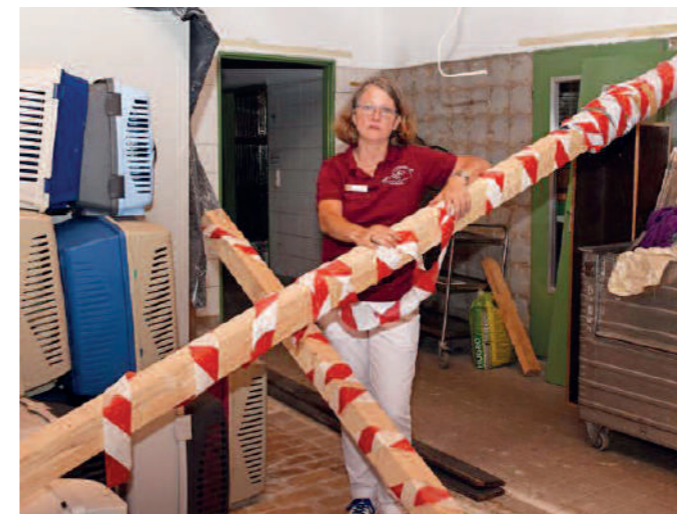
Unsere tierärztliche Leiterin Dr. Urte Inkmann im baufälligen Alten Katzenhaus – dicke Balken stützen die einsturzgefährdeten Wände ab.
